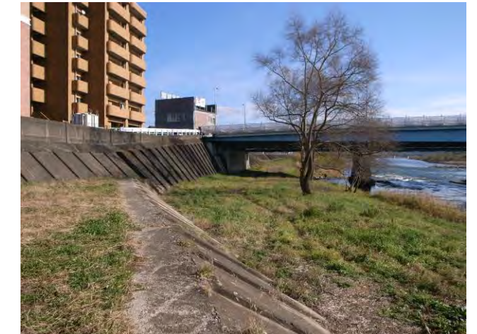
既設護岸により、安全に通行ができない (明治橋(下流方向)を望む)
