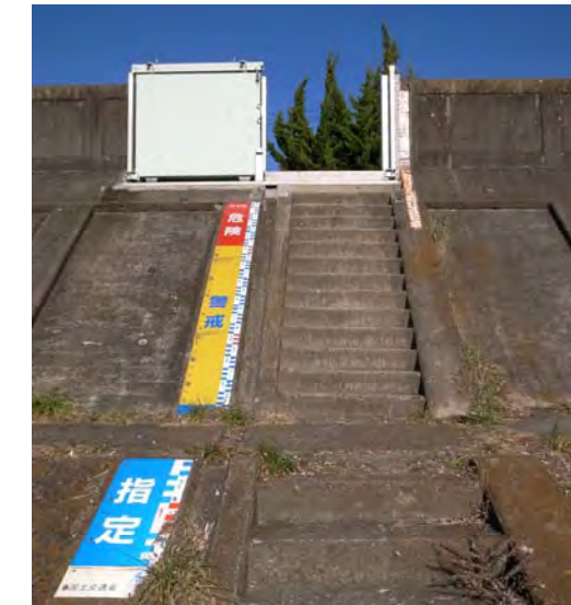
既設階段は基本的に管理用の階段であり、一般利用者が安全に昇降できない
